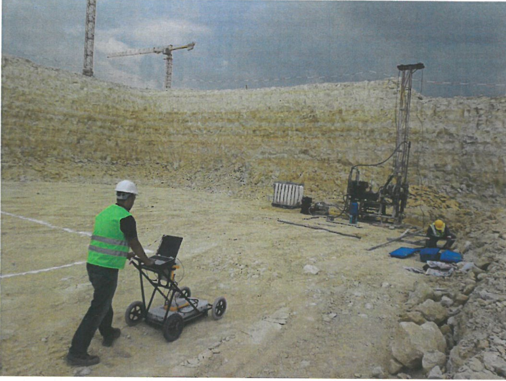
Tema İstanbul 1 Sitesi Temel Altı Jeo-radar ve sondaj çalışmaları. Eosen karbonatlılarına ait kireçtaşı ve killi-kireçtaşı birimleri.
