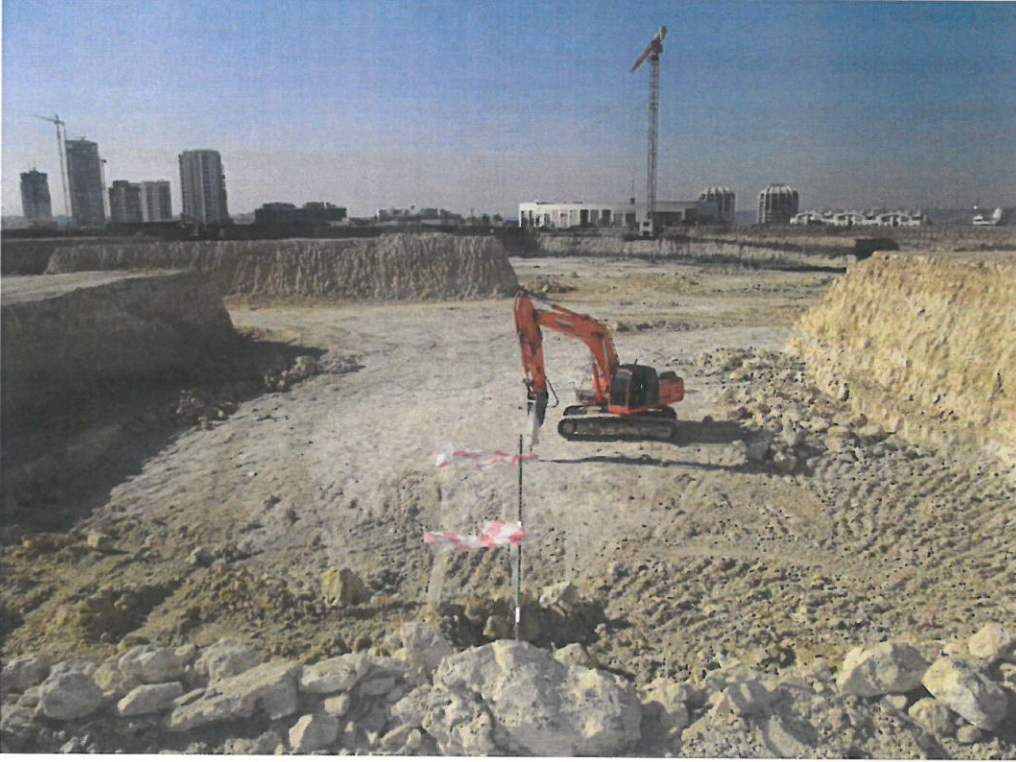
Tema İstanbul 1 Sitesi Temel kazıları. Eosen karbonatlılarına ait kireçtaşı ve killi-kireçtaşı birimlerinin kırıcılı ekskavatör marifetiyle kazılması işlemi.
